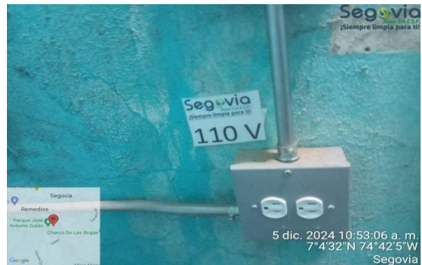
Foto N° 54: Señalización riesgo eléctrico parque automotor
