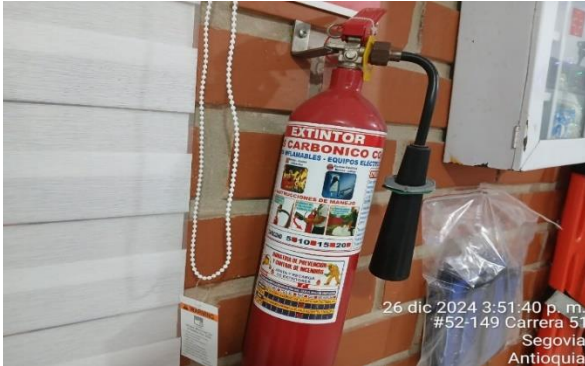
Foto N° 69: Inspección extintor oficina administrativa
