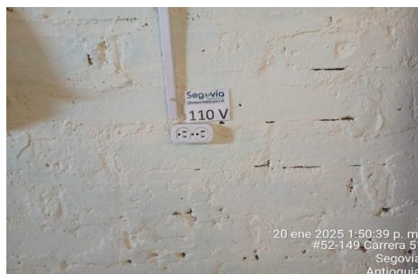
Foto N° 54: Señalización riesgo eléctrico bodega de barrido
