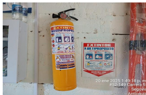
Foto N° 60: Inspección de extintor bodega de barrido
