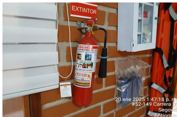
Foto N° 69: Inspección extintor oficina administrativa
