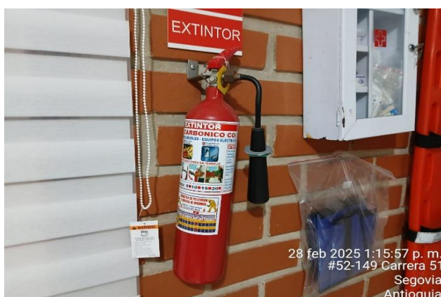
Foto N° 65: Inspección extintor oficina administrativa
