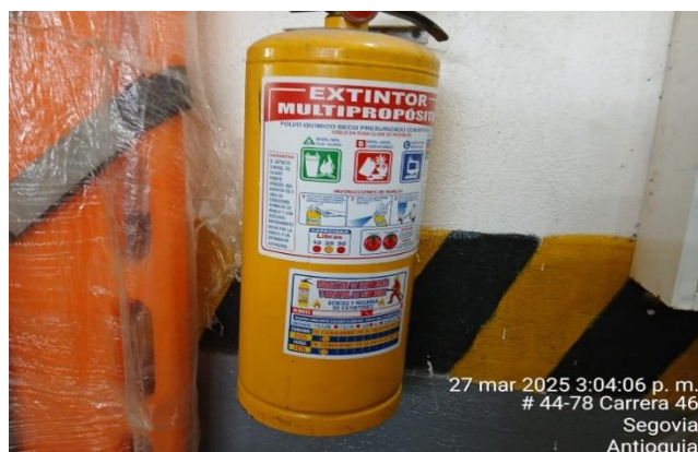
Foto N° 75: Inspección de extintor parque automotor
