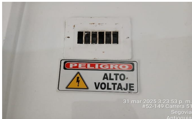
Foto N° 71: Inspección riesgo eléctrico oficina administrativa
