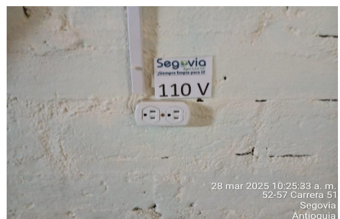
Foto N° 58: Señalización riesgo eléctrico bodega de barrido
