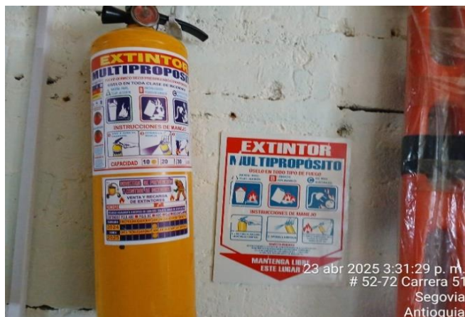
Foto N° 59: Inspección de extintor bodega operativa
