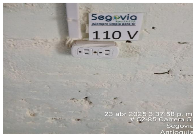
Foto N° 46: Señalización riesgo eléctrico bodega operativa
