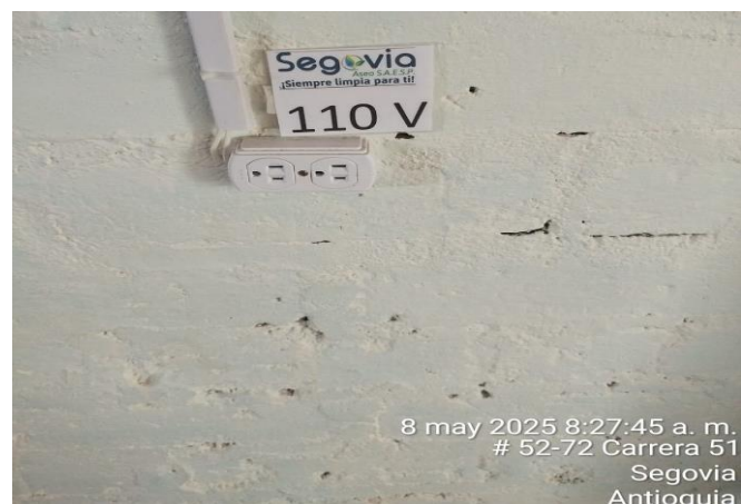
Foto N° 72: Señalización riesgo eléctrico bodega operativa
