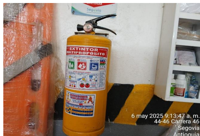
Foto N° 70: Inspección de extintor parque automotor
