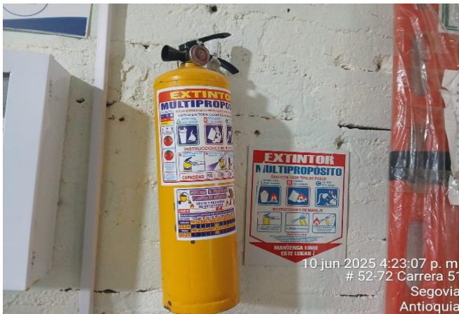
Foto N° 49: Inspección extintor bodega operativa
