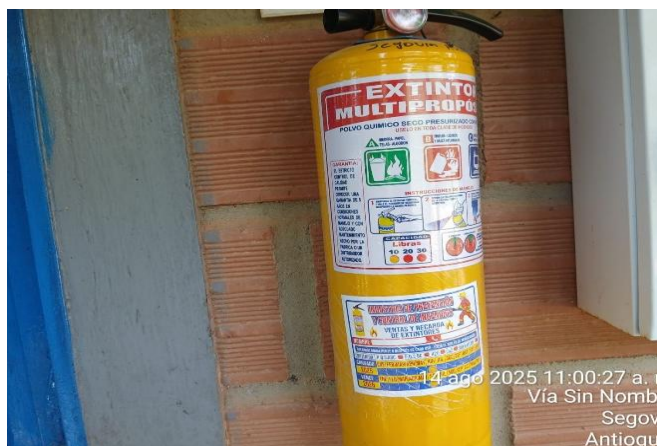
Foto N° 59: Inspección extintor caseta relleno Vera I
