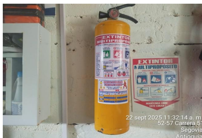
Foto N° 70: inspección extintor bodega operativa
