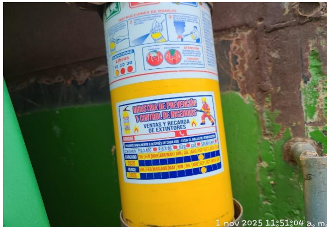
Foto N° 57: Inspección extintors de vehículo
