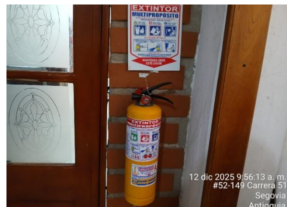
Foto N° 75: Inspección extintor oficina administrativa
